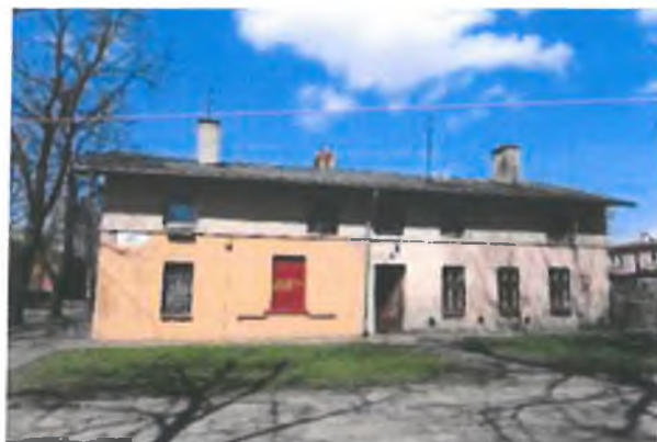
Zdjęcie 42. Budynek o złym stanie technicznym dachu przy ul. Kościuszki 32.
