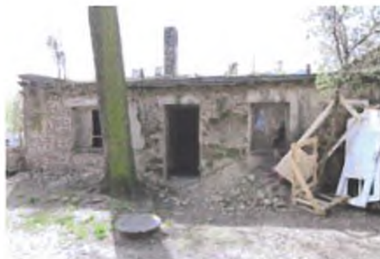
Zdjęcie 55. Obiekt w stanie katastrofalnym przy ul. Kościuszki 25
