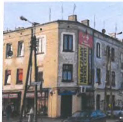
Zdjęcie 36. Zły stan elewacji – budynek przy ul. 1 Maja 70.
