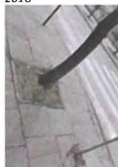
Zdjęcie 31. Nawierzchnia z płyt betonowych – stan średni
