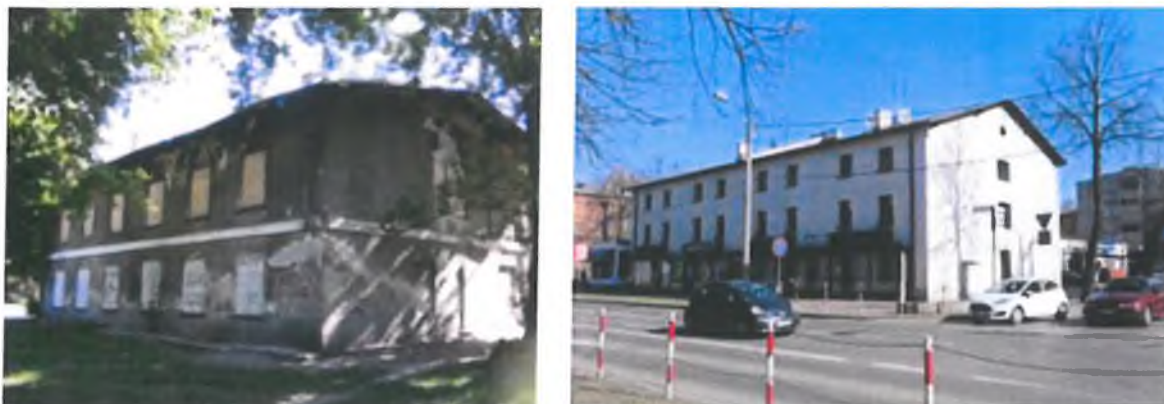
Zdjęcie 62. Budynki w złym lub bardzo złym stanie zachowania historycznej elewacji – zlokalizowane wzdłuż ul. 1 Maja
