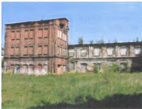
Zdjęcie 46. Budynek o bardzo złym stanie technicznym stolarki okiennej i drzwiowej przy ul. Dittricha 10j.
