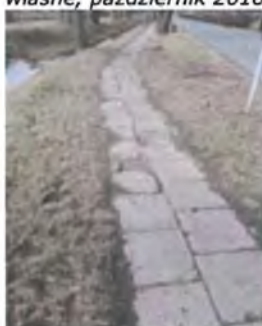
Zdjęcie 30. Nawierzchnia z płyt betonowych - stan zły
