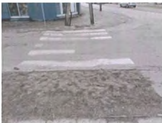
Zdjęcie 105. Zdegradowana nawierzchnia na ulicy Sienkiewicza
