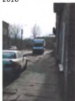
Zdjęcie 32. Nawierzchnia z płyt betonowych – stan zły
