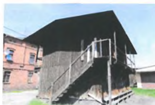
Zdjęcie 40. Komórka gospodarcza wewnątrz kwartału zabudowy przy ul. Kościuszki 37 – zły stan techniczny
