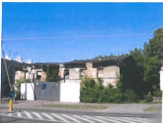
Zdjęcie 41. Budynek o bardzo złym stanie technicznym dachu przy ul. 1 Maja 68.
