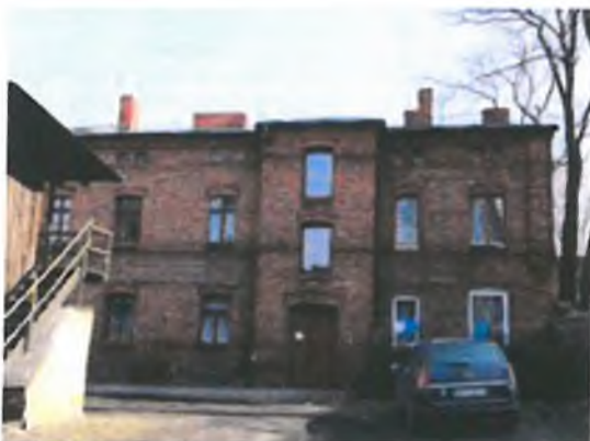
Zdjęcie 60. Budynek o złym stanie technicznym fundamentów przy ul. Wyszyńskiego 7.
