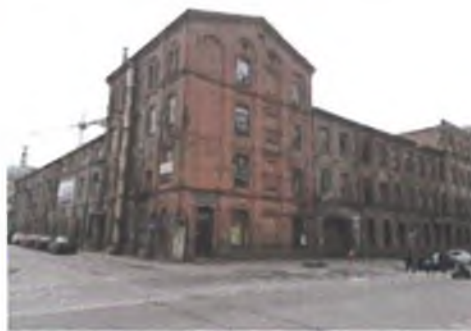
Zdjęcie 47. Budynek o złym stanie technicznym stolarki okiennej i drzwiowej przy ul. Limanowskiego 47.
