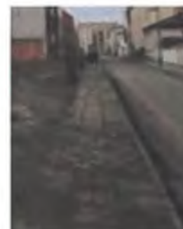
Zdjęcie 33. Nawierzchnia z płyt betonowych – stan zły
