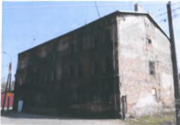
Zdjęcie 35. Bardzo zły stan elewacji – budynek przy ul. Chopina 7.
