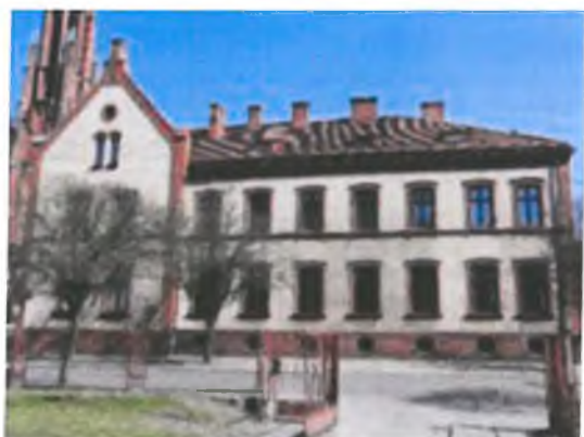
Zdjęcie 43. Budynek o średnim stanie technicznym dachu przy ul. Narutowicza 30.
